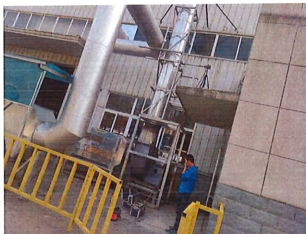
DA001 热废气排放口（◎1）
